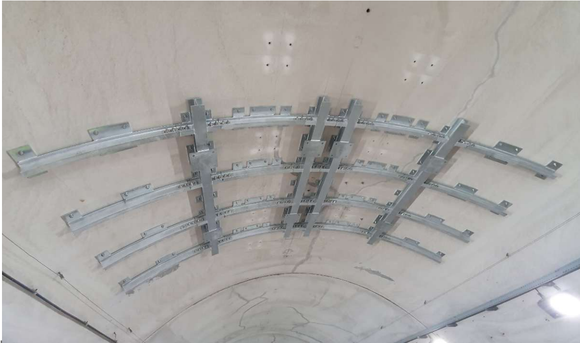
방재시설 보완 강지보(빔타입)
